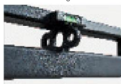
6 Pontos de ancoragem fixos na viga
